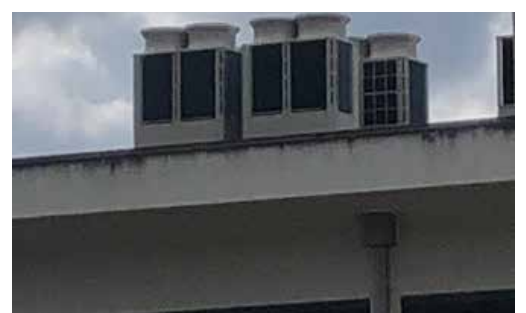
MUST-511 | Centro de Negócios - Aquisição de Equipamento - Substituição AVAC Sala Polivalente.
