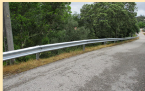
Rails e Outros Elementos de Segurança - Vários locais do Concelho
