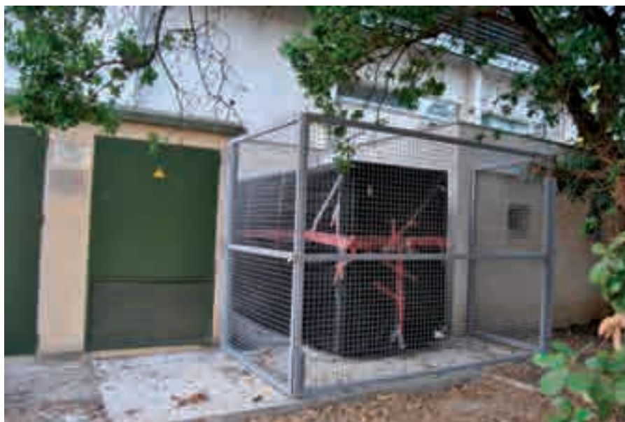
Sistema de eficiência energética e gerador - 63.250€
