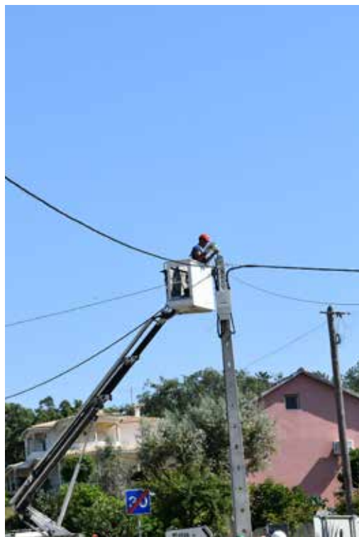
Iluminação Pública: Eficiência Energética - Substituição da luminárias a rede pública
