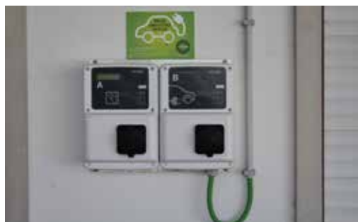
Aquisição e Instalação de Carregadores Elétricos: Parque Logístico Municipal
