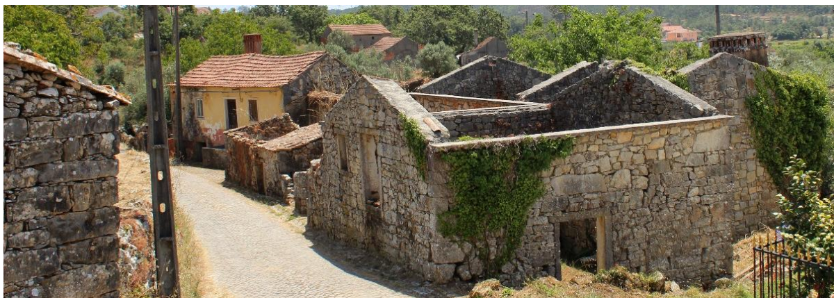
Figura 24. Edifícios degradados na ARU de Granja
