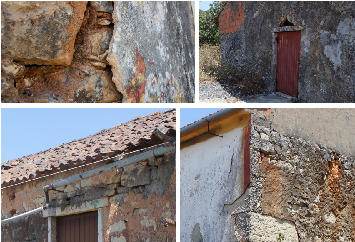
Figura 22. Exemplos de patologias dos elementos construtivos dos edifícios na ARU de Granja
